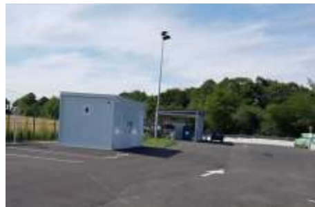
Remplacement du local gardien +création Nouvelle zone couverte pour le stockage des déchets toxiques
